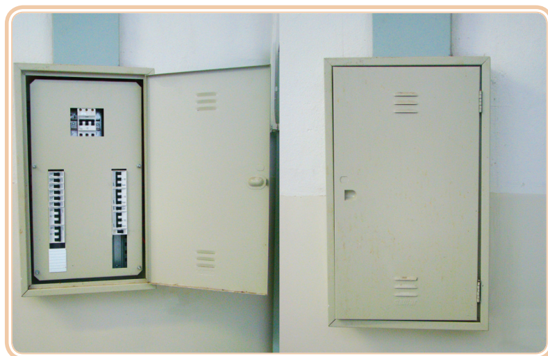
Figura 4.7: Quadro de distribuição com seus disjuntores
